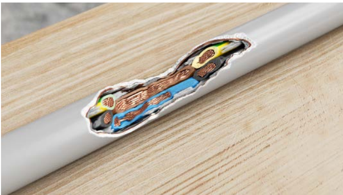
Nagerschaden an Kabel / Dégâts causés par un rongeur
