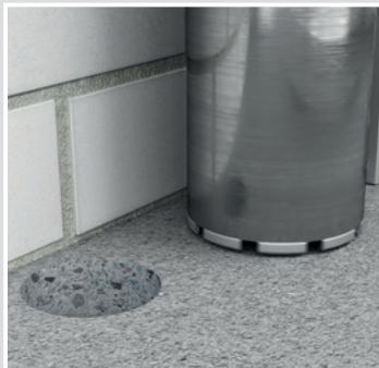
...oder passende Kernbohrung bei nachträglichem Einbau erstellen.
