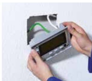
Der grosszügige Installationsraum erlaubt eine einfache Wartung der eingesetzten Geräte.
