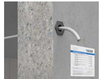
Wanddurchführung durch Brandschutzwand aus Beton.
