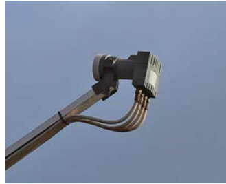
Hier werden 4 Koaxial-Leitungen für den Empfang angeschlossen.
