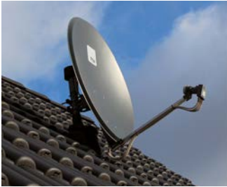
Anschluss einer digitalen Satelliten-Empfangsanlage.
