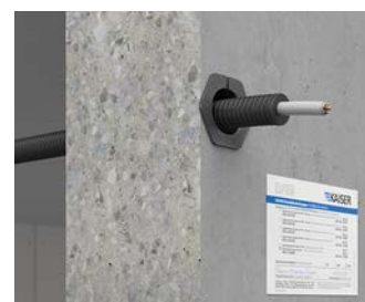
Wanddurchführung durch Brandschutzwand aus Beton.
