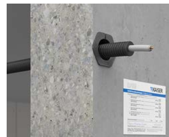
Passaggio attraverso muro antincendio in calcestruzzo.
