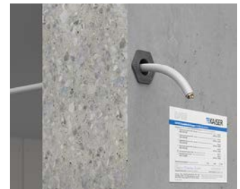
Passaggio attraverso muro antincendio in calcestruzzo.
