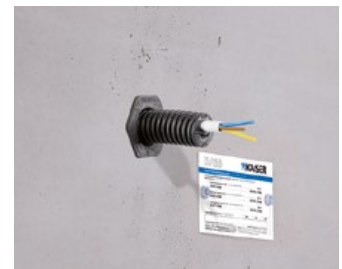
Passage à travers une cloison coupe-feu en béton.
