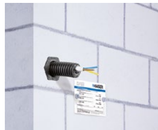
Passage à travers une cloison coupe-feu en grès.
